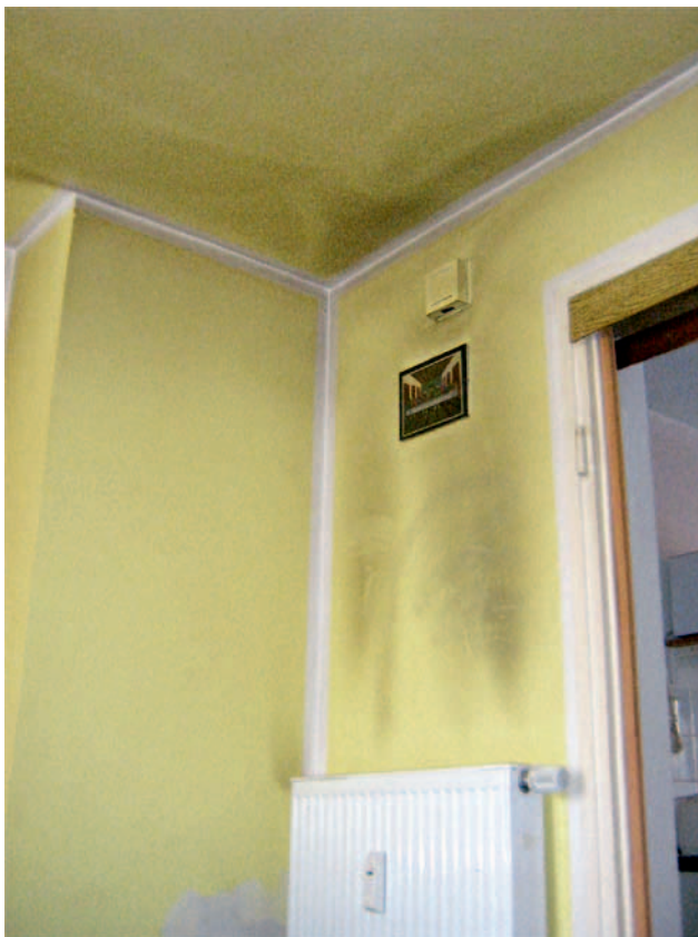
Fogging wird das Phänomen genannt, wenn sich ein schwarzer Belag von mittel- und schwerflüchtigen Schadstoffen auf Wänden bildet. Fotos: Dr. Carl
